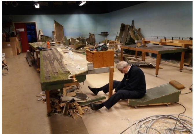
Anläggningen står på över 130 ben, alla skruvade i golvet med 2 skruv. Leif Petersson demonterar här Helgeberga.
